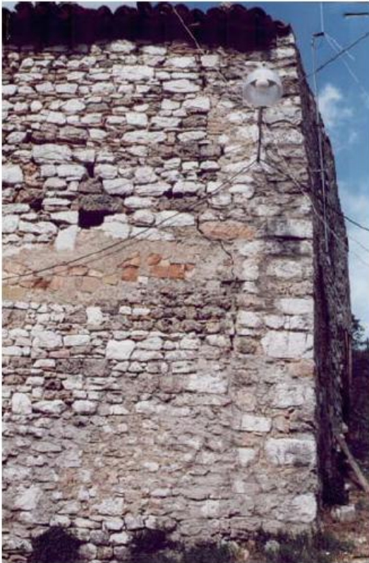
Figura 2-129: Immagini dell'edificio con codice 7692 con riferimento ad alcuni quadri fessurativi
